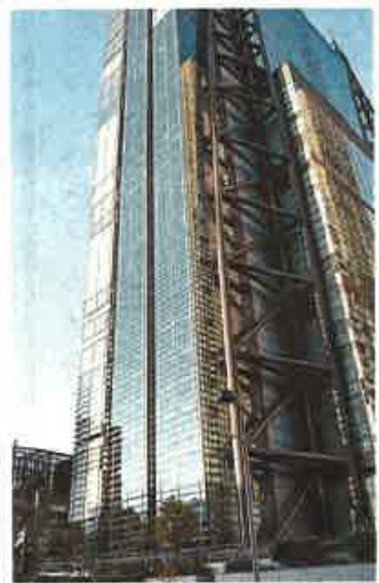
日本テレビホールディングスの本社ビル=東京都港区
